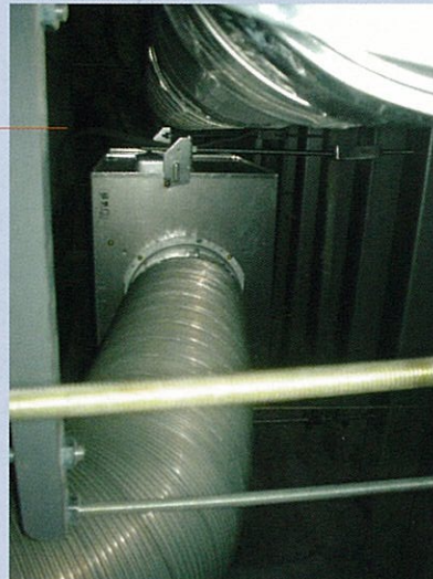
外気排出専用ダクト
