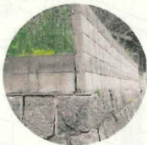
築壁上のブロック塀 の危険性
