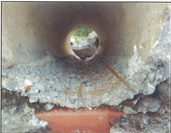
損傷した下水道管
