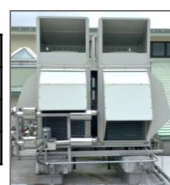
循環加温式ヒートポンプ
