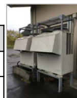
ヒートポンプユニット
