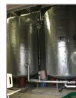
給湯タンク設備
