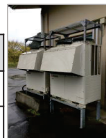
ヒートポンプユニット
