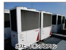
ガスヒートポンプエアコン
